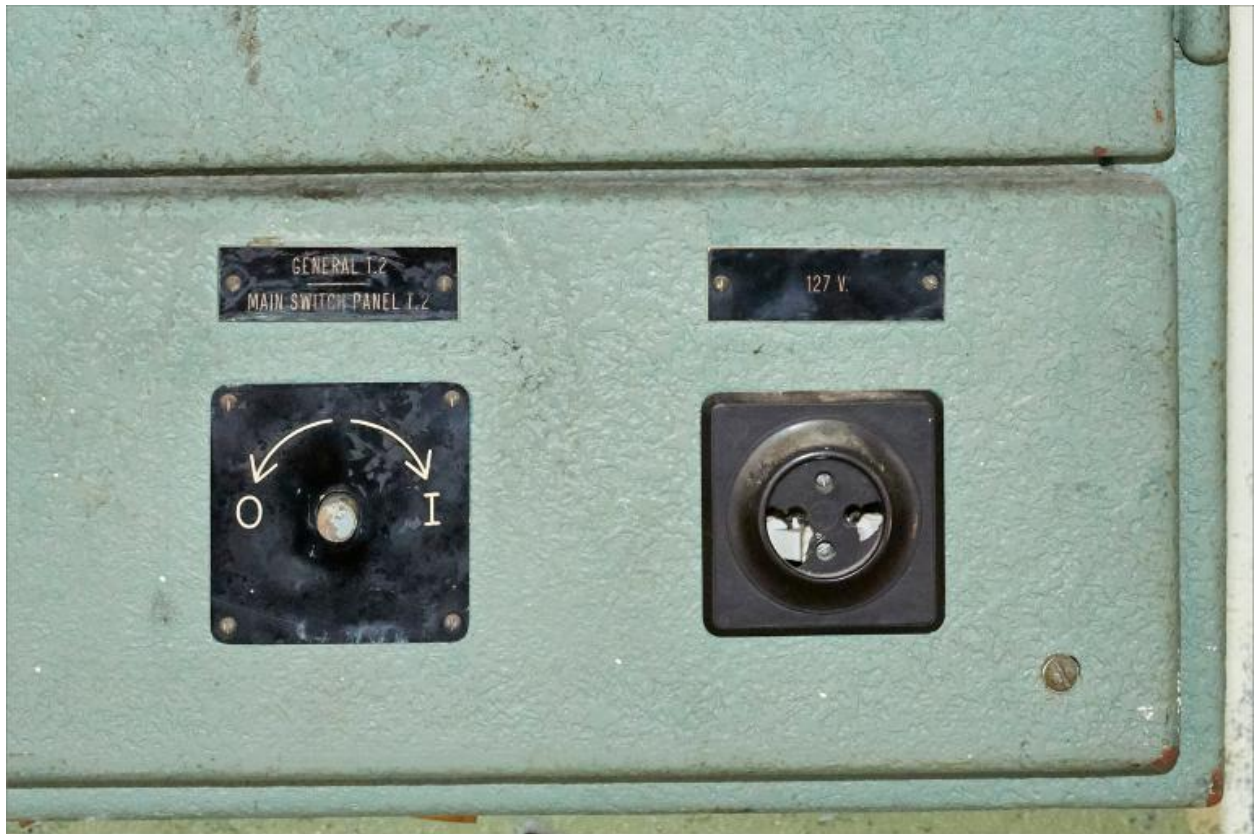
Galerie de liaison entre les pavillons, vue intérieure, détail d'un tableau de distribution électrique (fermé), partie inférieure, détail : coupe-circuit (à gauche) et prise de courant 127 v.
