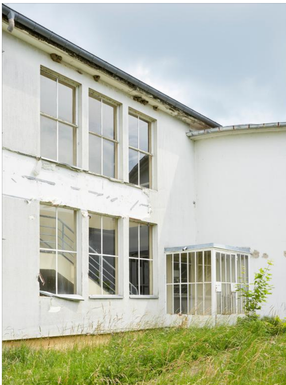
Bâtiment II, élévation partielle Ouest à hauteur du point d'intersection avec la galerie (à droite), vue vers le Sud-Est.
