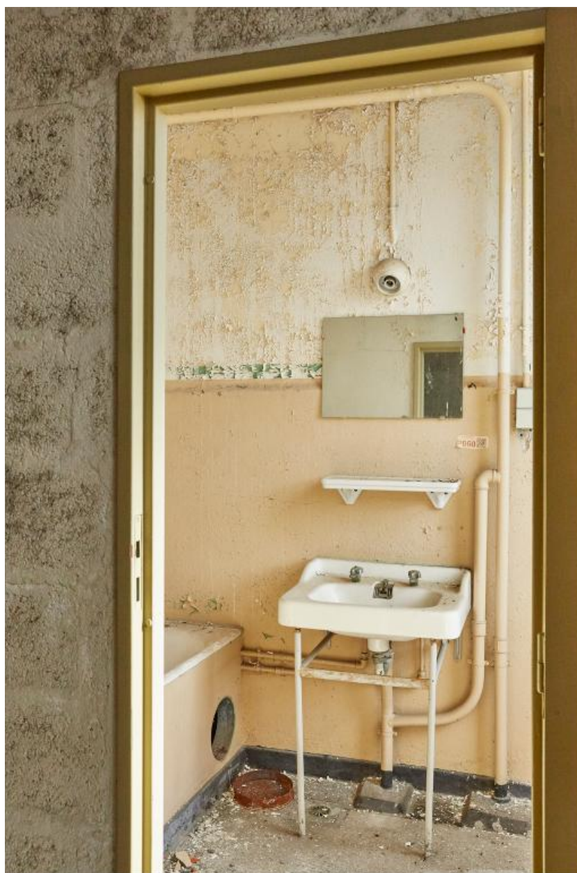
Bâtiment II, vue intérieure, détail d'une salle de bain : lavabo et baignoire (à gauche).
