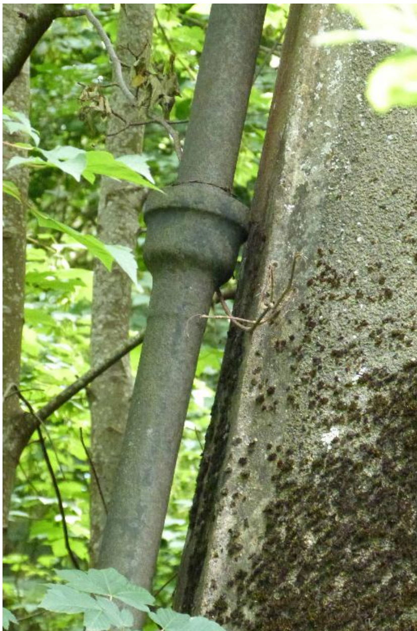
Château d'eau de la papeterie de Raon l'Étape, vue de détail d'un raccord de tuyaux en fonte
