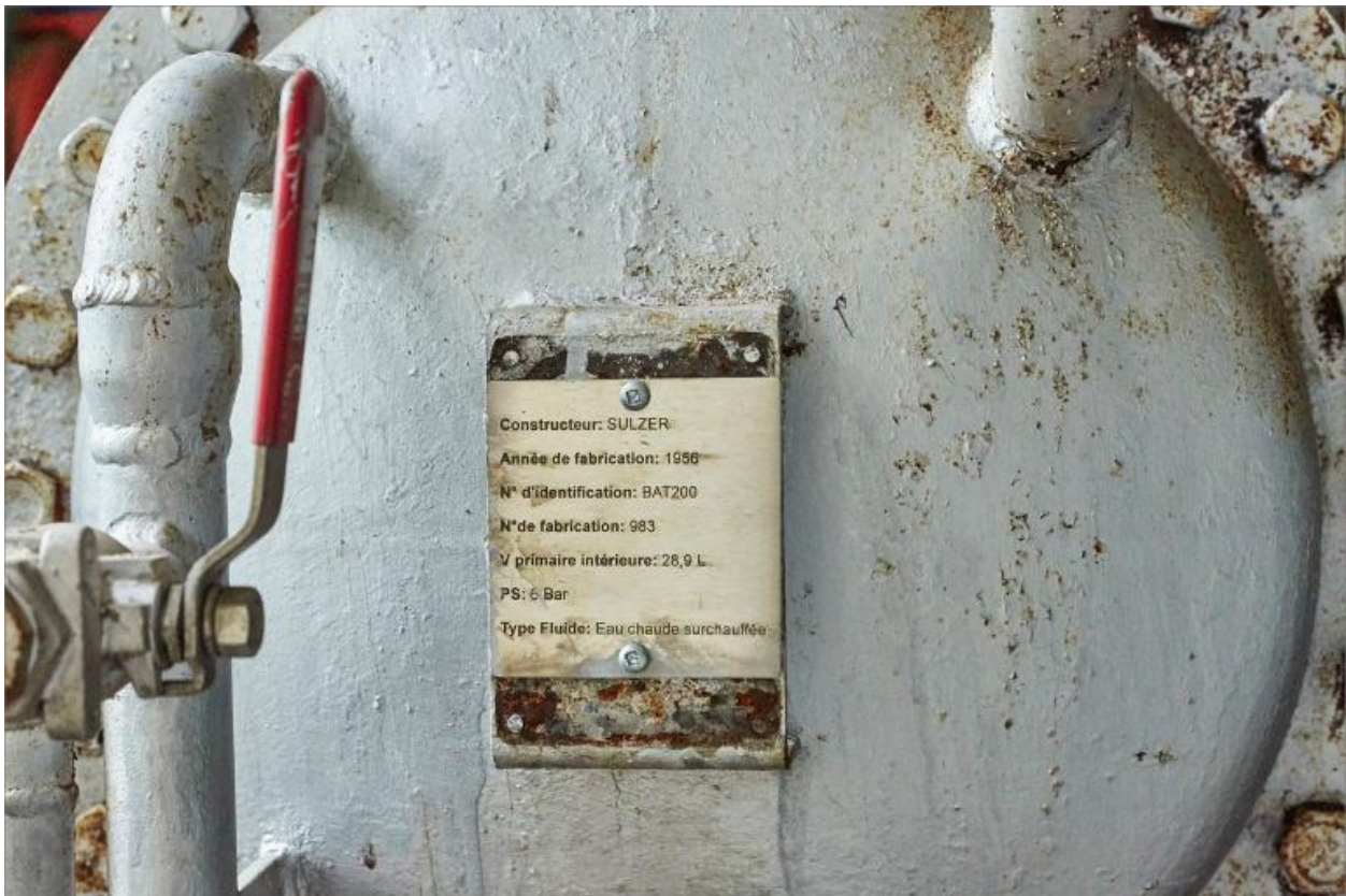
Bâtiment JJ, vue intérieure au rez-de-chaussée, détail : surchauffeur d'eau, la plaque du constructeur.
